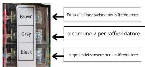
Scatola di derivazione per refrigeratore d'acqua
